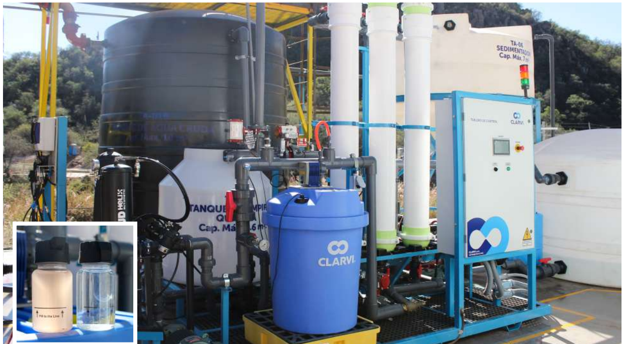
Planta de tratamiento con ultrafiltración para remoción de arsénico.
