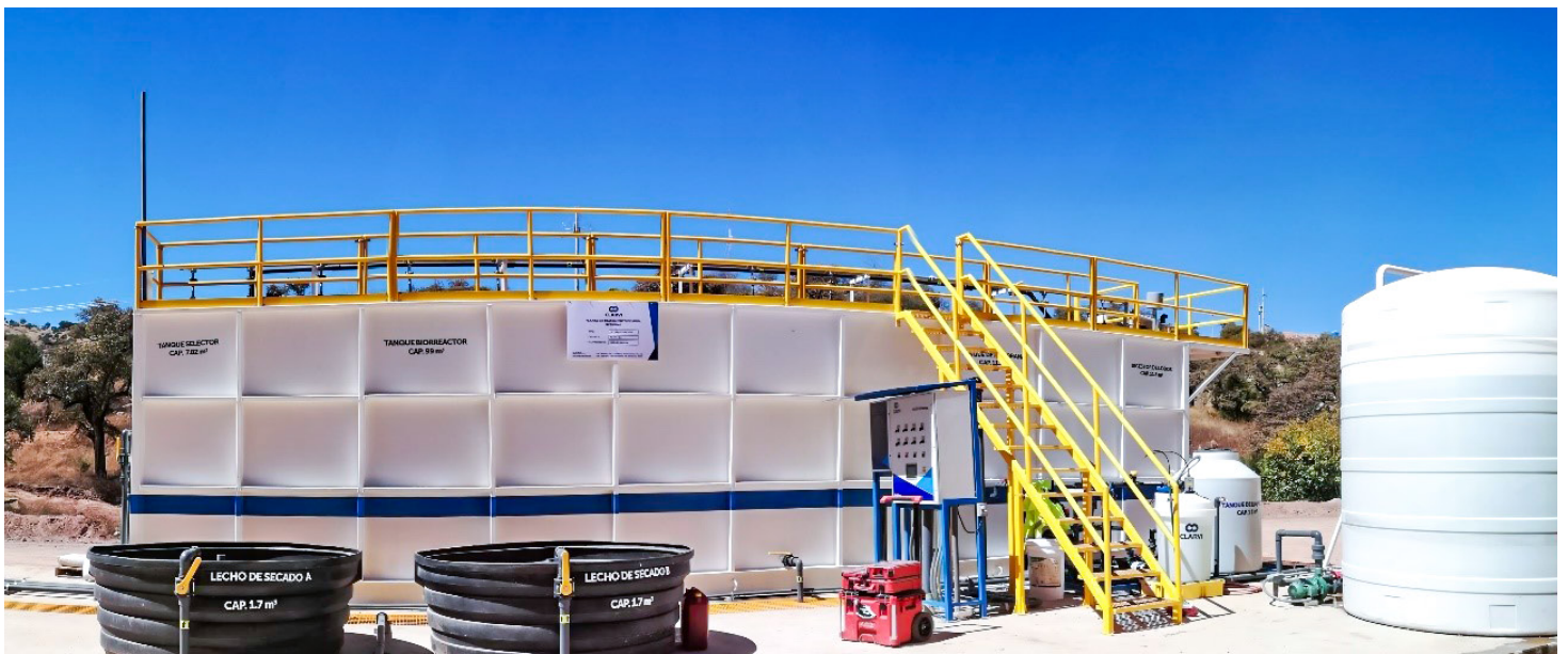
Sistema de tratamiento de agua residual con ultra filtración.
