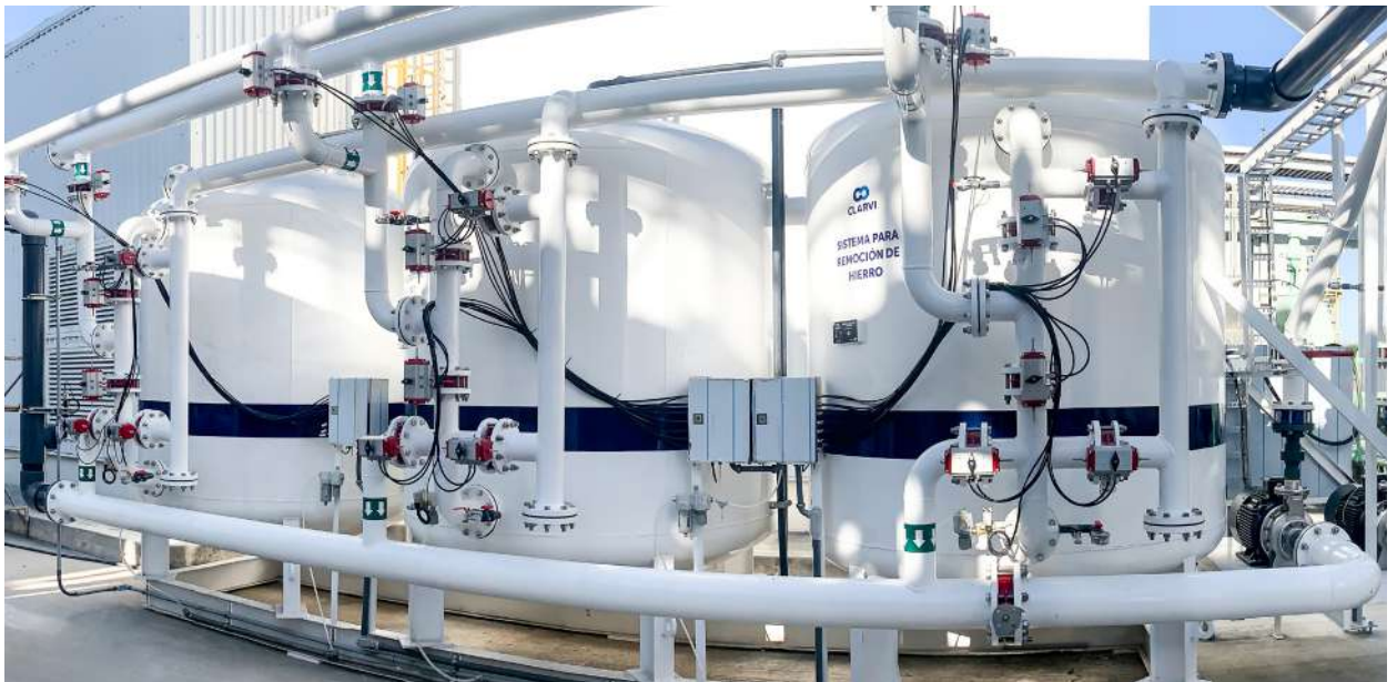
Sistema de tratamiento de agua para la remoción de hierro.
